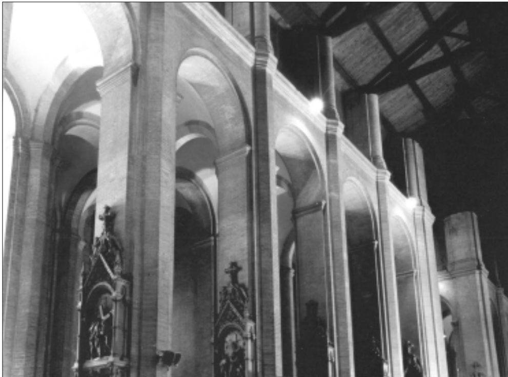
FIG. 3. AUGUSTE DELORT. SAINT-AUBIN DE TOULOUSE. La nef inachevée et la charpente provisoire de 1858.
