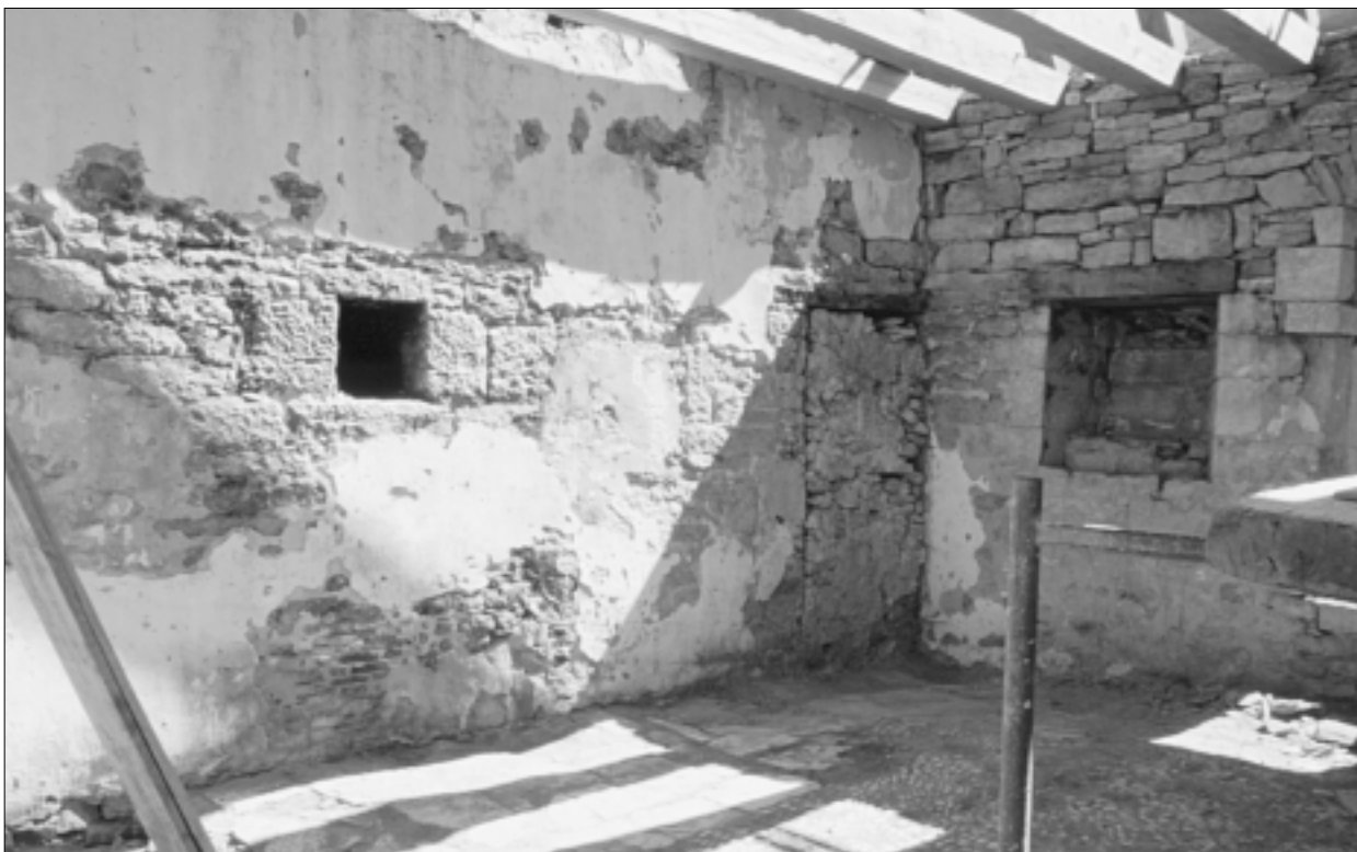
FIG. 16. MAISONS JUMELLES N° 1. Vue de la salle de l'habitation nord depuis le sud-ouest, lors des travaux de restauration. Cliché V. Rousset, 2002.
