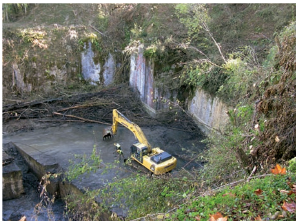
FIG. 4. LE FOND DE L'EXCAVATION DE LA CARRIÈRE, VERS LE SUD-EST. Cliché F. Veysièrre, © Inrap.
