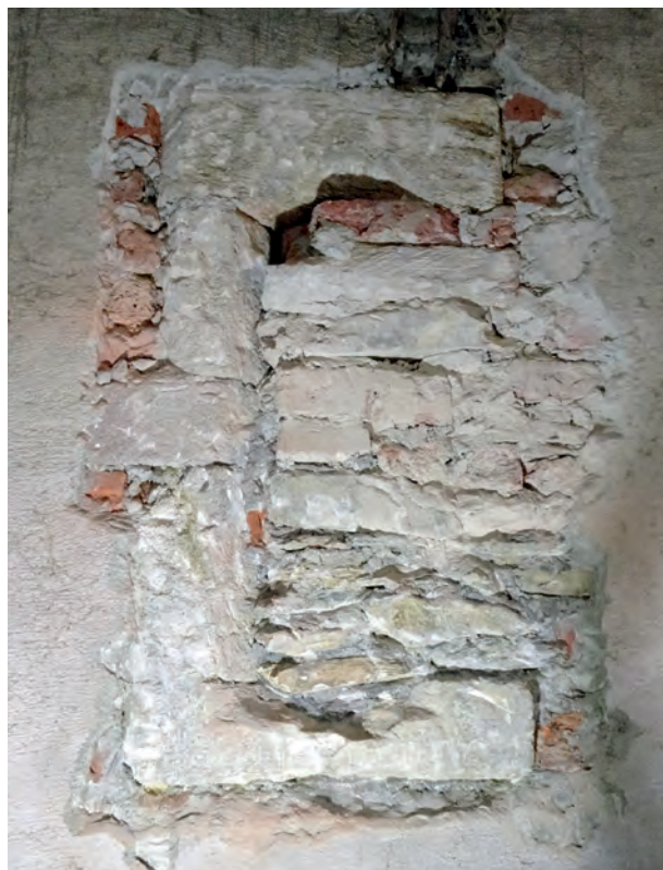
FIG. 12. FENÊTRE F1 découverte après sondage de l'enduit. Élévation extérieure mur M2. Cl. V. Rousset, 2019.
