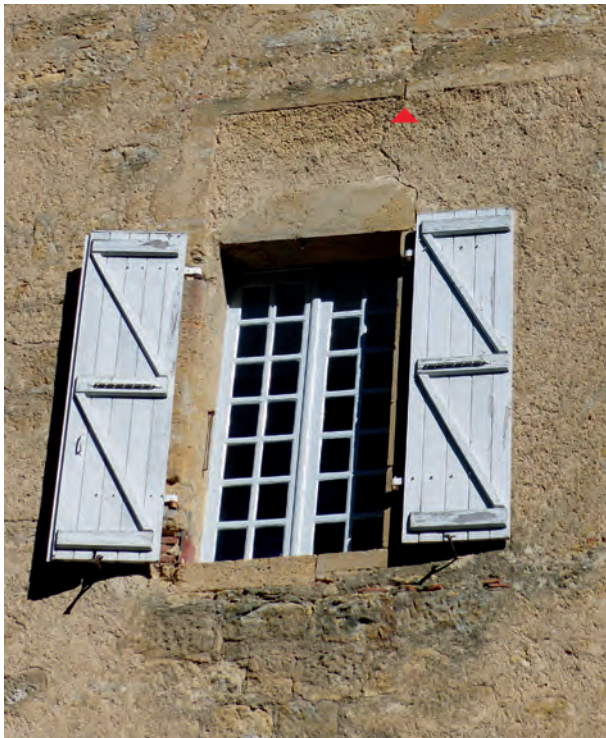
FIG. 17. VESTIGES D'ANCIENNES FENÊTRES, fenêtre du XIX e siècle construite dans une croisée, remplaçant elle-même une fenêtre à réseau. Cliché C. Viers.
