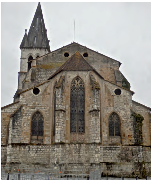
FIG. 3. CHEVET. De nettes déliaisons trahissent l'adjonction des combles par dessus les collatéraux. L'image montre aussi la position singulière des contreforts latéraux de l'abside chargeant l'extrados des fenêtres. Cliché B. Sournia.
