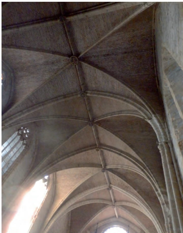
FIG. 18. VOÛTE D'ORTHEZ. Au-dessus du tas de charge, appareillé en calcaire, les nervures résultant d'une campagne du XVI e siècle sont appareillées en grès. Les quartiers sont appareillés en brique. On discerne clairement, à l'arase supérieure du tas de charge, le hiatus constructif entre l'ouvrage du XIV e siècle et l'achèvement de la voûte au XVI e siècle. Cliché B. Sournia.
