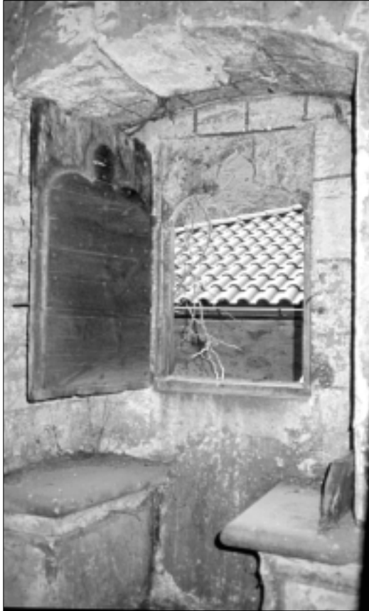
FIG. 58, LA ROQUE-BOUILLAC (Aveyron). Volet plein à double planchage clouté, dans une fenêtre trilobée (XV e siècle ?)
