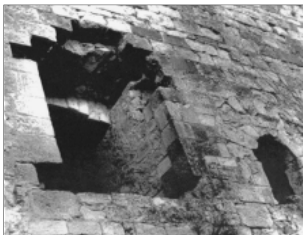
FIG. 20. DONJON DE CASTELNAUD-LACHAPELLE (Dordogne), état de la fenêtre « romane » en 1974, avant restauration. Les arrachements montrent que le linteau et les arrières-linteaux qui constituaient le couverture initial de la baie ne pouvaient être qu'en bois. Cette facilité technique, inhabituelle pour un ouvrage royal, a fait passer cette fenêtre pour un ouvrage moderne, ce qui en a justifié la destruction lors d'une ancienne campagne de restauration. (Cliché château de Castelnaud).
