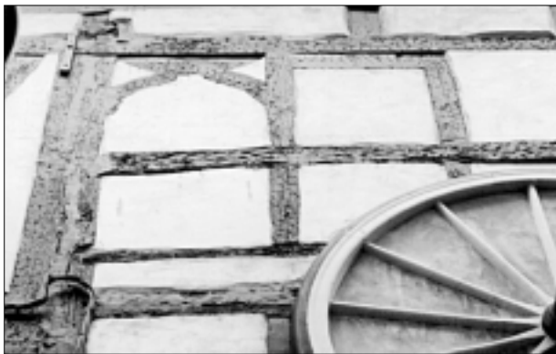
FIG. 48. FENÊTRES MÉDIÉVALES INSCRITES DANS DES ÉLÉVATIONS EN PANS DE BOIS. GRENADE-SUR-GARONNE, maison de ville (fin XIII e siècle). CALMONT-DU-PLANCAGE (Aveyron), fenêtre droite à colonnette de section carrée (XIV e ou première moitié XV e siècle?). BAYONNE (vestige de fenêtre cintrée sur appui filant ?).
