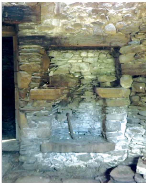
FIG. 19. ÉVIER aménagé dans le mur nord de la salle du premier étage. Cliché M. Scellès.
