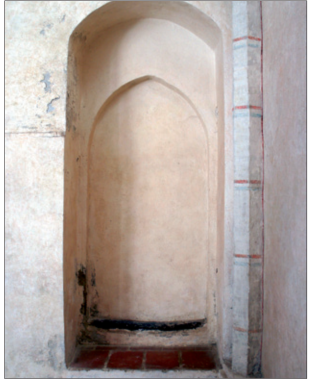
FIG. 12. SACRISTIE, PREMIÈRE TRAVÉE, MUR SUD, porte murée vers l'église, état 2011. Cliché Guy Ahlsell de Toulza.
