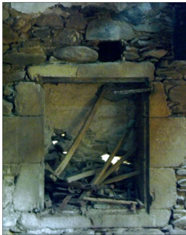
FIG. 20. PLACARD aménagé dans le mur nord de la salle du premier étage. Cliché R. Chabbert.
