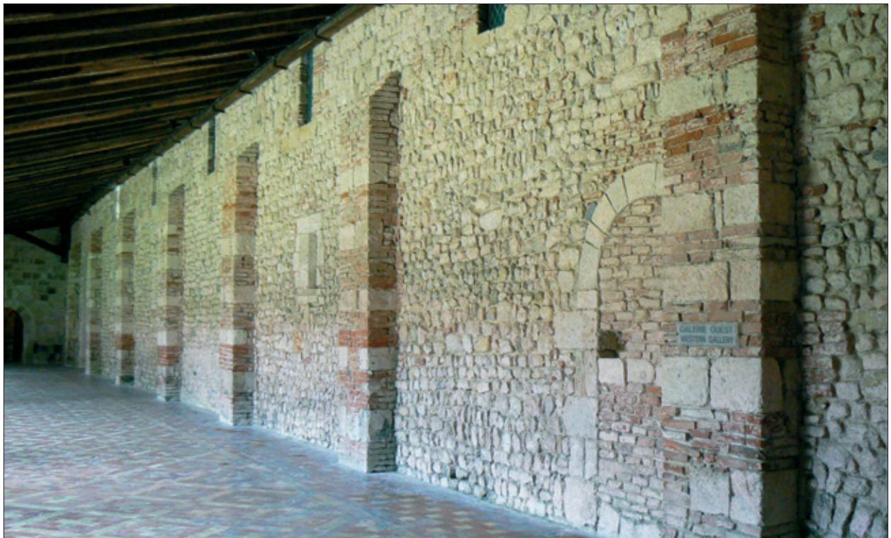
FIG. 11. MUR OCCIDENTAL DU CLOÎTRE du nord vers le sud. Cliché Q. Cazes.
