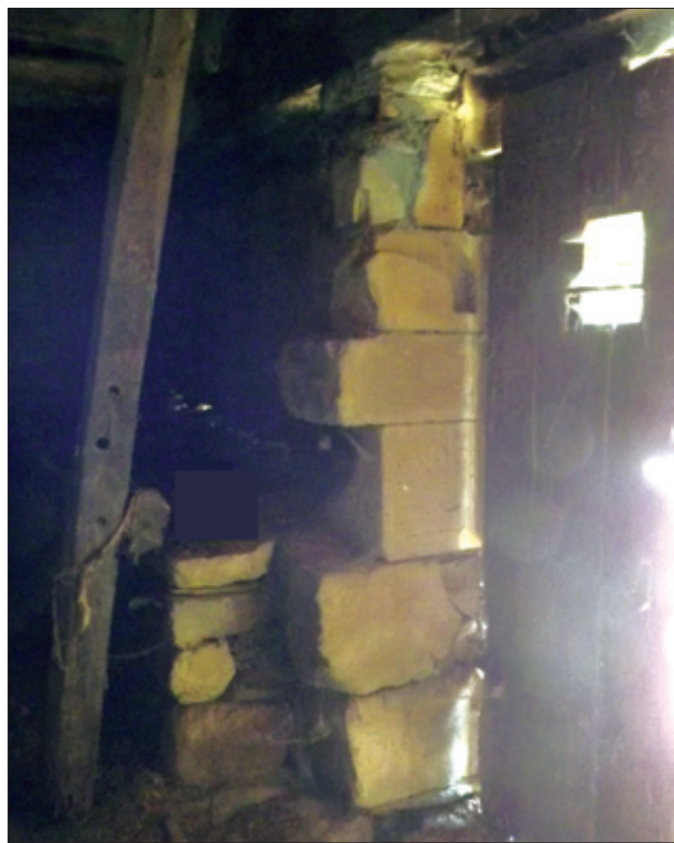
FIG. 10. REZ-DE-CHAUSSÉE : arrachement de la maçonnerie derrière le trumeau. Cliché R. Chabbert.
