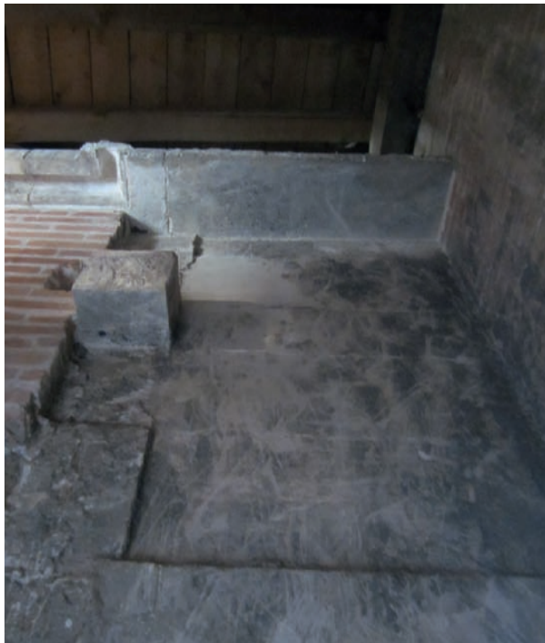
FIG. 20. VUE DE L'ARRACHEMENT DE LA DALLE COUVRANT LA GALERIE DU TRIFORIUM laissée en attente au droit de la vis d'Orléans. Au premier plan, les pierres en attente du mur extérieur du triforium inachevé. Cl. J.-L. Rebière.
