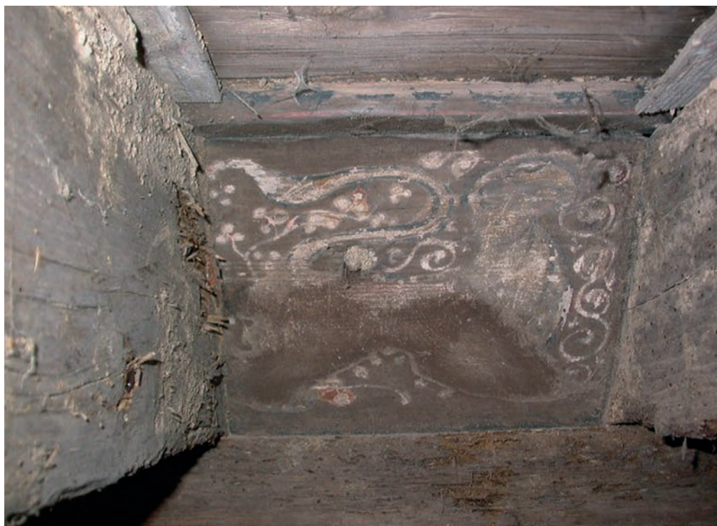
FIG. 14. VUE D'UN CLOSOIR ANIMALIER : on y voit la silhouette d'un lion passant sur un fond de rinceaux à traitement végétal. L'humidité a eu raison des couleurs dont on ne perçoit que de faibles traces. Le fond était rouge. Cl. J.-L. Rebière.
