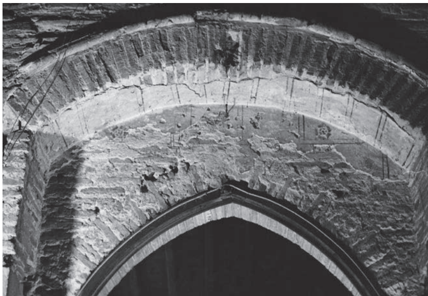
FIG. 16. VESTIGE DES PEINTURES MURALES DU RÉFECTOIRE au-dessus de la porte du cloître, du côté intérieur. État en 1980. Photo D. Cazes.
