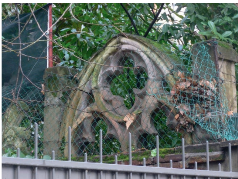
FIG. 8. PARTIE SUPÉRIEURE DU REMPLAGE DE PIERRE D'UNE FENÊTRE de l'ancien réfectoire des Augustins, 38 avenue de la Garonnette à Toulouse. Photo D. Cazes.
