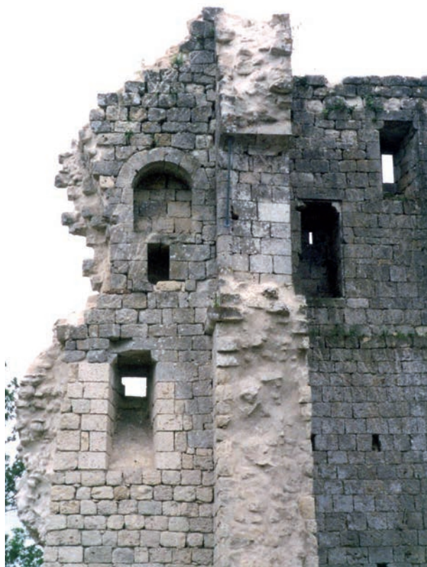
FIG. 16. DUNES. SITE DU « TURAS ». Partie supérieure du mur nord de la tour. Photo Ch. Darles.
