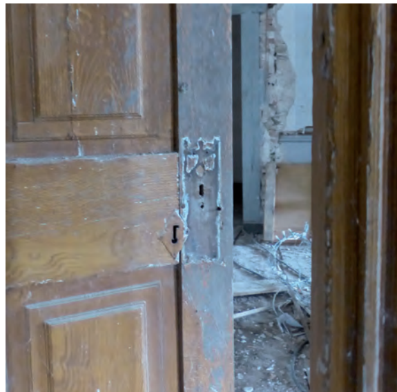
FIG. 5. BRUNIQUÉL, VESTIGES DES CLOISONS qui isolaient le couloir central d'accès au premier étage de la galerie. chambranle à pilastres cannelés et fantôme d'une platine de serrure en tôle découpée. Cl. G. Séraphin.
